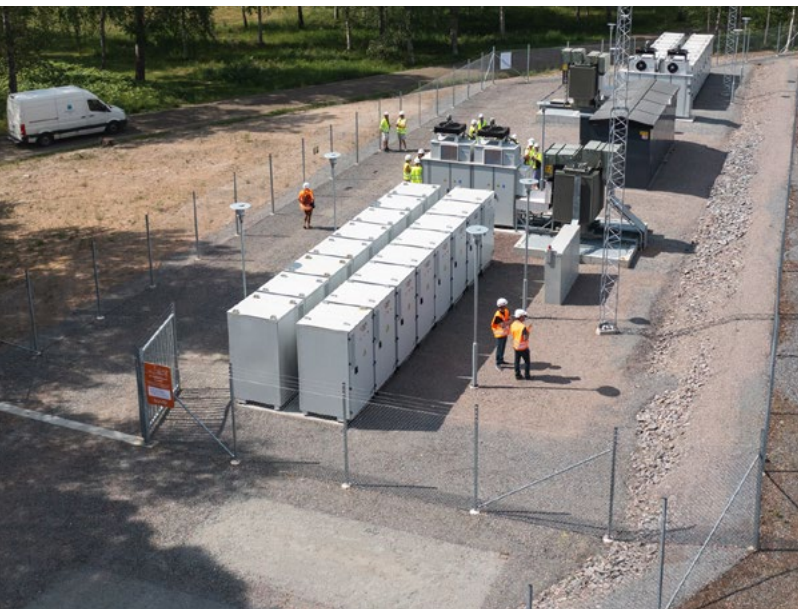
I Grums finns ett av Ellevios batterilager, som ska bidra till balansen i elsystemet genom att det snabbt går att ladda upp eller ladda ur, beroende på behov. Foto: Ellevio/Fredrik Karlsson.
